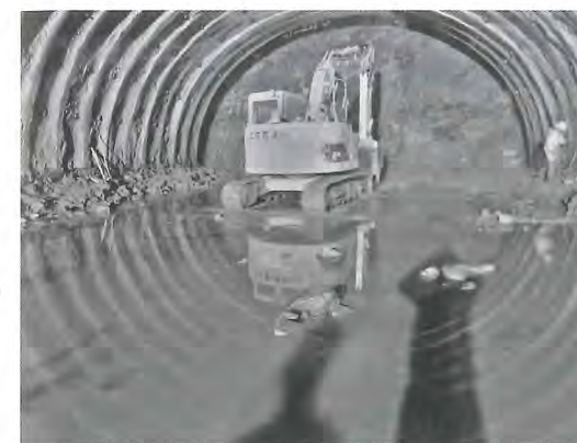
写真-1 湧水による帯水状況(上半盤)
