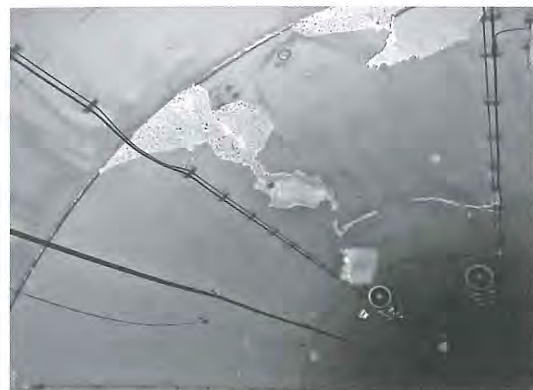
写真-7 圧さの状況(スパン37)
