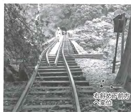
写真-3 出口方坑口部の変位状況 6)
