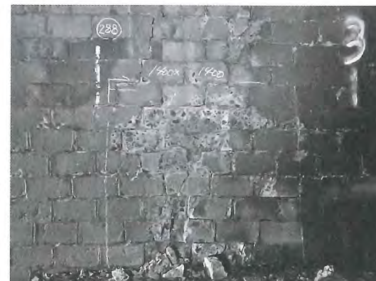
(a) 左側壁のコンクリートブロックの剝落
