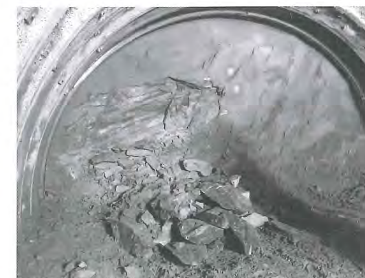
写真-2 切羽鏡面の崩落(鋼製支保工建込み直後)
