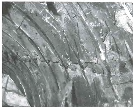
写真-2 支保工の変状状況
