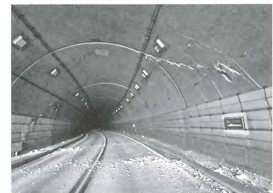
写真-6 せん断ひび割れの状況(スパン4～5)
