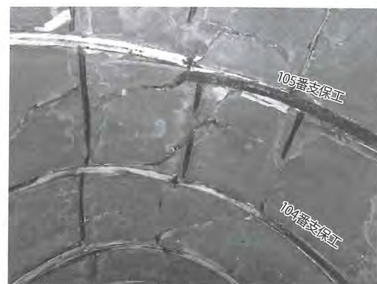
写真-1 S4付近の天端部の変状 6)
