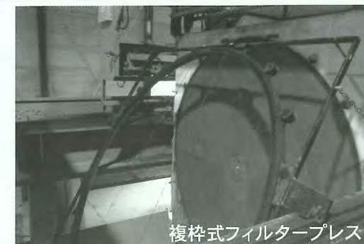
100.0 m³/Hr 濁水処理設備
