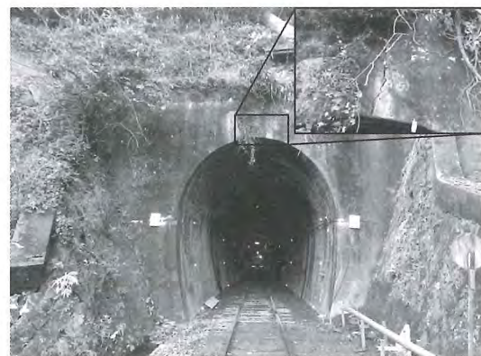
(a) 坑門クラウン部に発生したひび割れ
