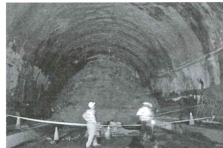
切羽崩落状況
