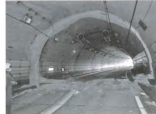
写真-4 盤ぶくれの状況(スパン12～13)
