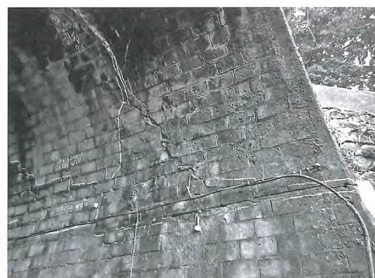
(b) 右側アーチのひび割れおよびずれ
