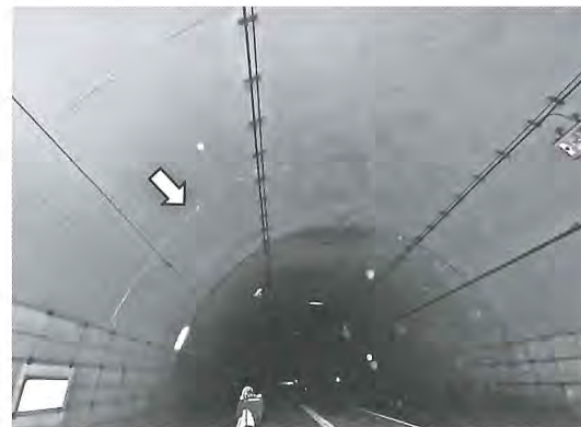
写真-8 輪切り状のひび割れ状況(スパン96)
