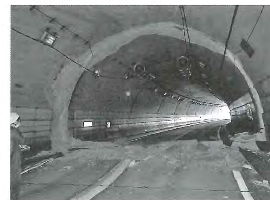
写真は盤ぶくれの状況
