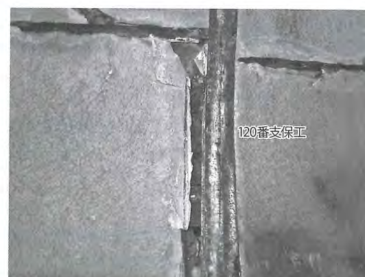
写真-2 S6付近の右側壁部の変状
