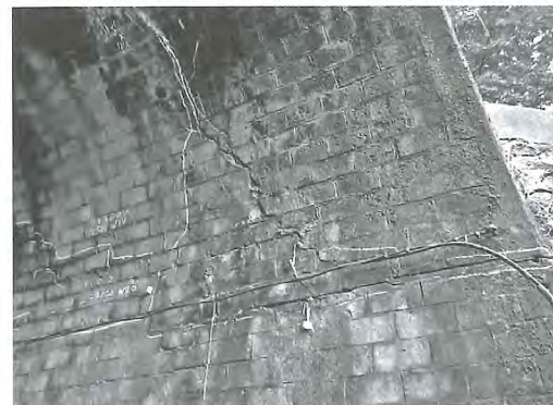
写真は戸下トンネル起点方坑口部右側アーチのひび割れおよびずれ
