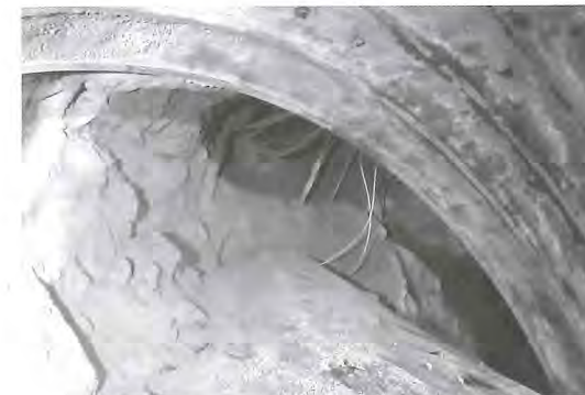
写真-4 フォアポーリング崩落
