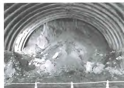
写真-3 本坑崩落状況
