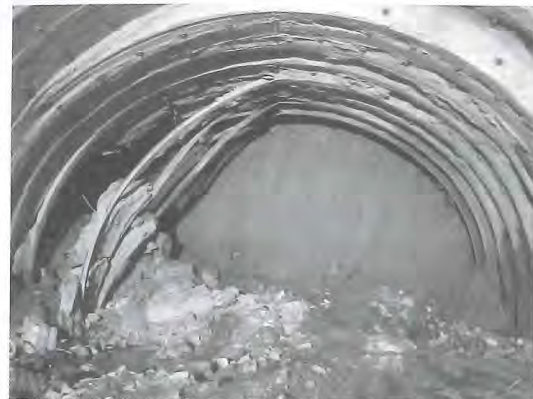
写真-1 支保変状状況(葉片状蛇紋岩)
