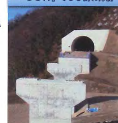
『CSA』でひび割れ抑制
