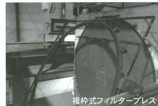
100.0 m³/Hr 濁水処理設備
