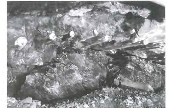
写真-5 長尺鋼管先受け工の沈下状況
