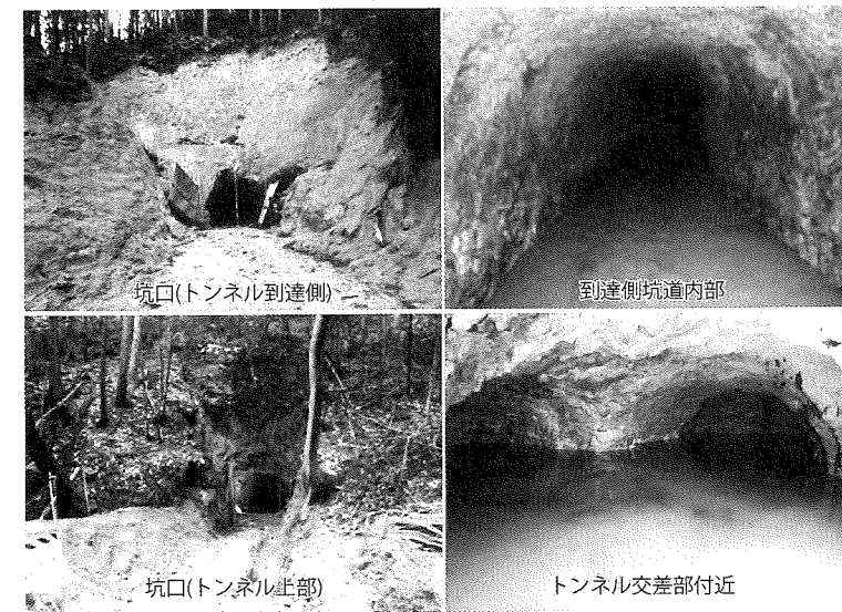
写真-2 廃坑道の状況
