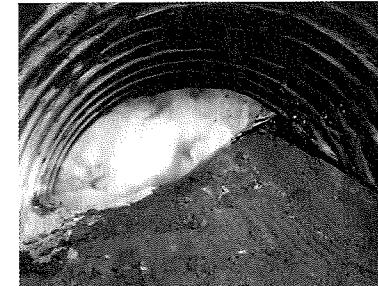
土砂流出状況
