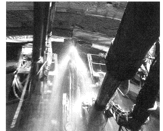
写真-4 湧水状況(ロックボルト孔)
