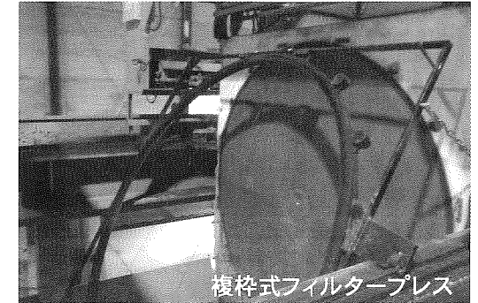
100.0m 3 /Hr 濁水処理設備
