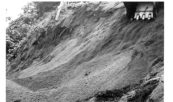
写真-11 斜面上に堆積するボラ層
