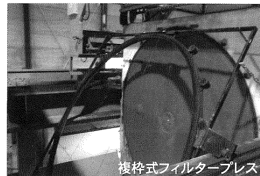
100.0 m 3 /Hr 濁水処理設備
