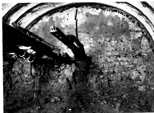
写真-2 連続孔・割岩孔削孔状況(ドリルジャンボにSABロッドを付けて孔や溝を掘削)
