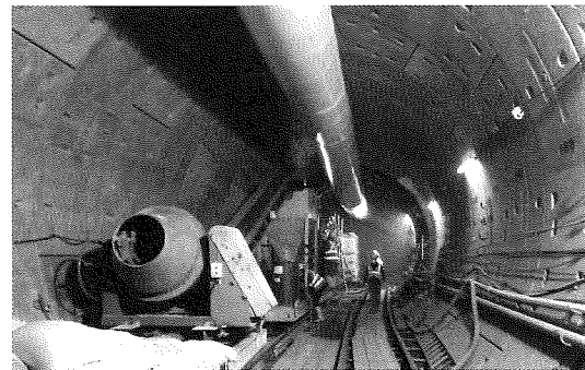
写真-7 連絡坑仮設備(本線トンネル内)
