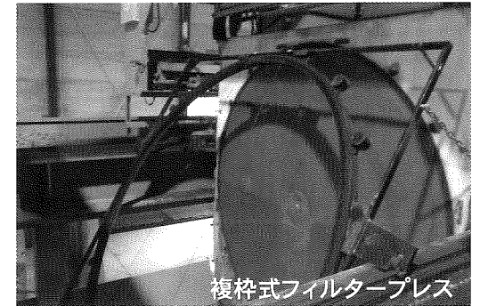
100.0m 3 /Hr 濁水処理設備
