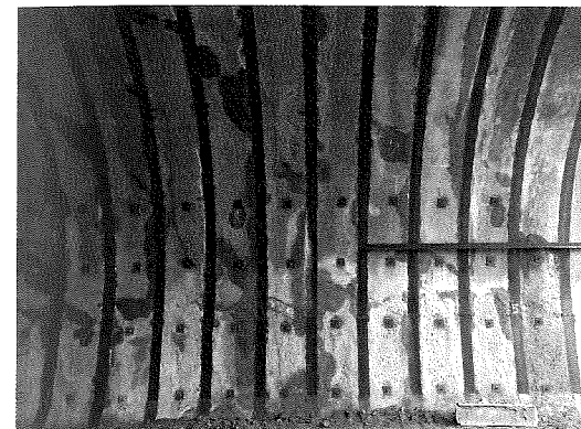
写真-4 支保変状(吹付けひび割れ)状況 2)
