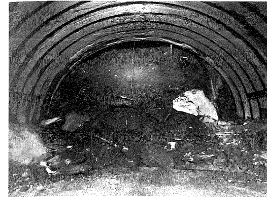
写真-3 切羽崩落状況(支保No.26)
