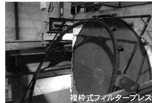
100.0 m 3 /Hr 濁水処理設備
