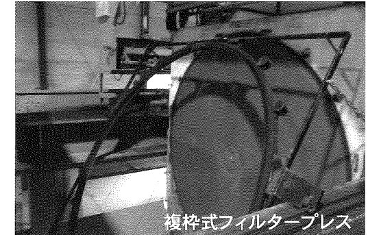
100.0 m 3 /Hr 濁水処理設備
