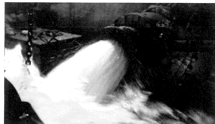
水抜きボーリング孔からの湧水状況
