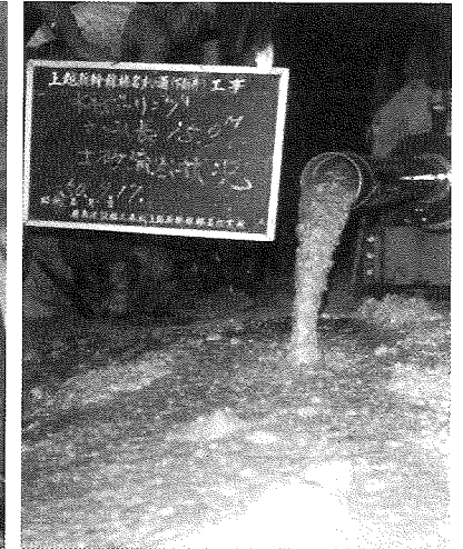
水平ボーリング孔からの軽石層の流出状況
