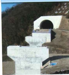
『CSA』でひび割れ抑制
