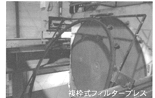
100.0m 3 /Hr 濁水処理設備
