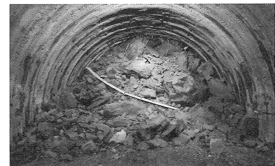
写真-2 坑内崩落状況
