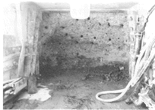
写真-1 想定外支障物
