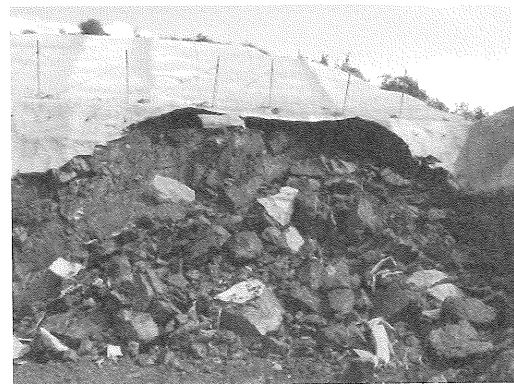
写真は赤色頁岩による法面崩壊(起点側坑口)
