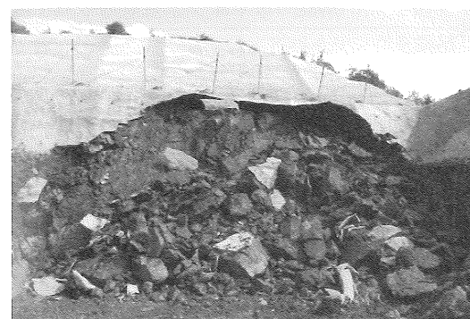
写真-2 赤色頁岩による法面崩壊(高木トンネル起点側坑口)
