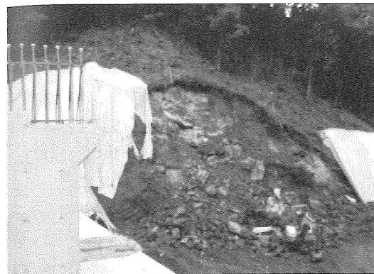
写真-1 赤色頁岩による法面崩壊(田代地区)
