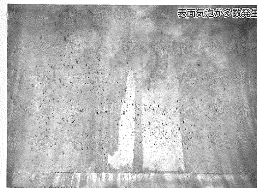
写真-1 覆工コンクリート下半部の初期欠陥
