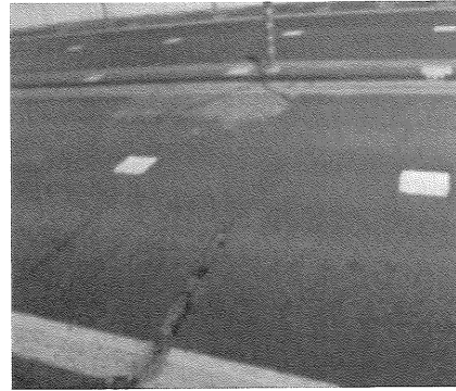
写真-1 路面クラック
