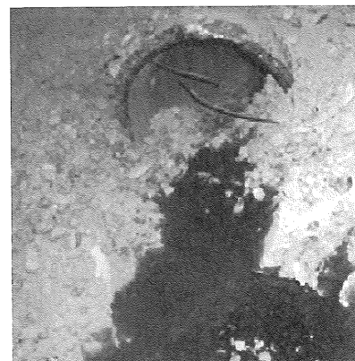
写真-11 中央排水管下部の湧水状況
