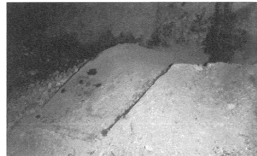
写真-3 消火栓箱抜き部断面の下半脚部の変状
