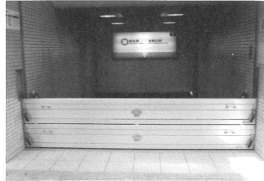
写真-3 駅出入口止水板
