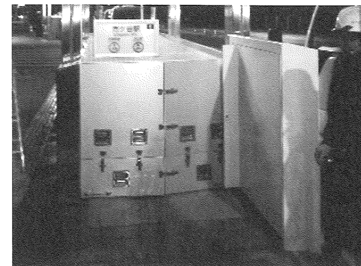
写真-10 横型折戸式防水扉
