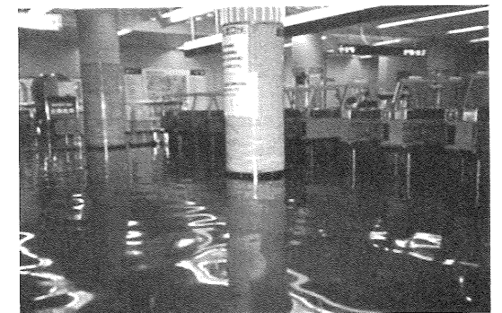
写真-2 溜池山王駅浸水事例
