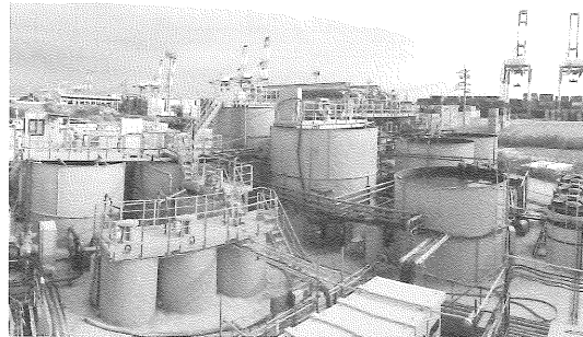
写真-3 調整槽, 余剰泥水槽
