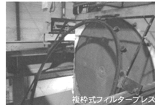
100.0m 3 /Hr 濁水処理設備
