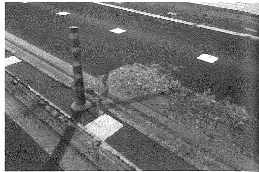
写真-1 アスファルト舗装面に生じた横断クラック 支保パターンはインバートがないCIIパターンで施工された。
