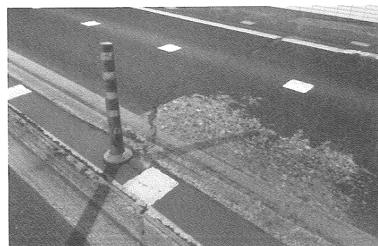
写真はアスファルト舗装面に生じた横断クラック
