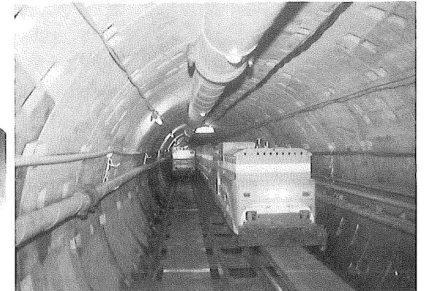
宮ヶ瀬導水路トンネル工事 超長距離トンネルの無人搬送状況
