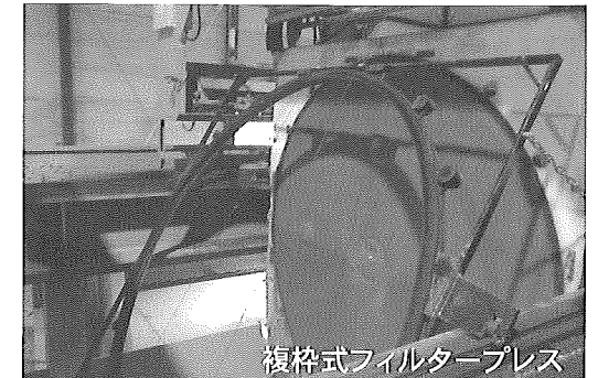
100.0 m 3 /Hr 濁水処理設備
