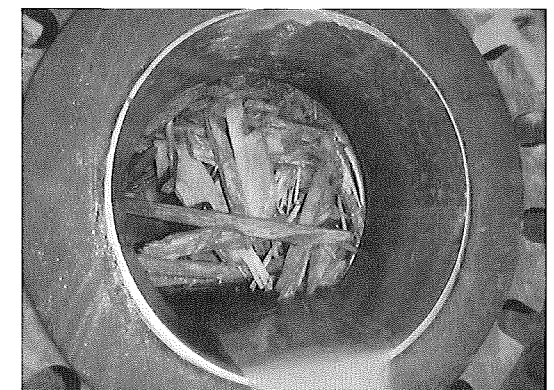
写真-10 FFUポンプ閉塞状況
