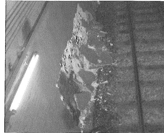
写真-3 吹付けモルタルのはく落
