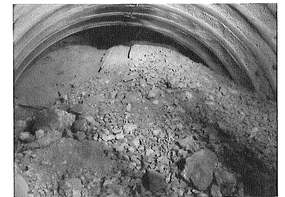
写真-2 層境付近(15km790m)の破碎性泥岩の崩落状況
