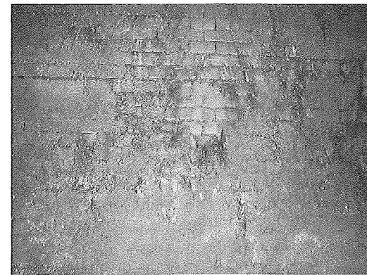
写真-5 煤煙が付着し目視困難な例
