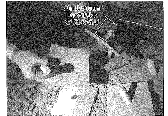
写真-4 ロックボルト破断状況
