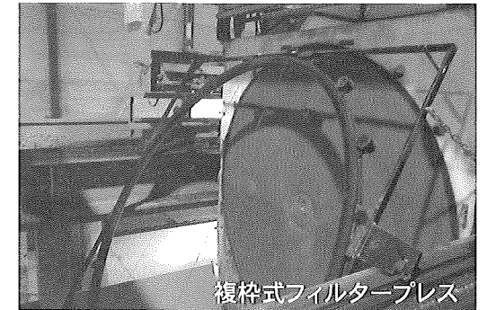
100.0m 3 /Hr 濁水処理設備
