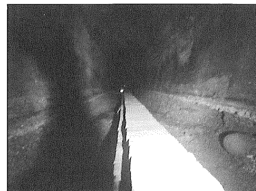
写真-3 洗掘箇所状況
