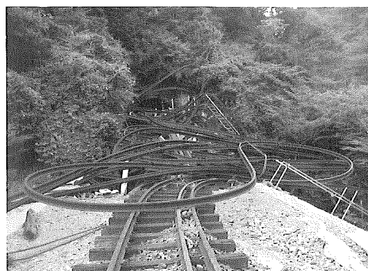
写真-1 線路流出状況
