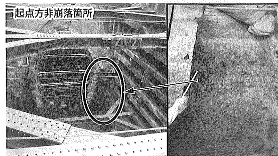
写真-7 非崩落箇所地山状況
