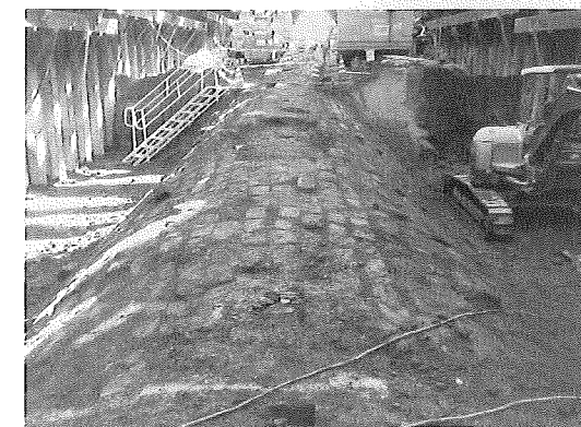
写真-4 崩落区間アーチ部状況
