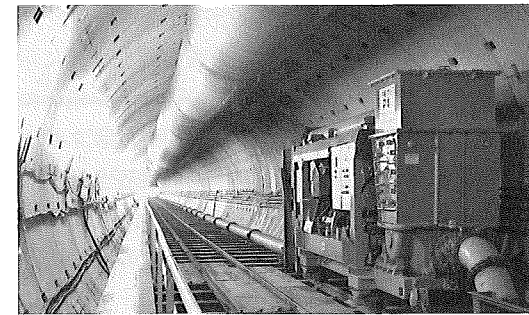
写真-1 排土圧送ポンプ(中継ポンプ)
