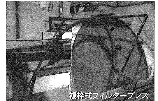
100.0 m³/Hr 濁水処理設備
