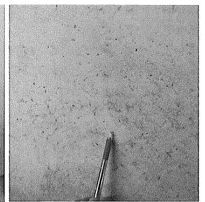
写真-8 壁部の空気泡痕
