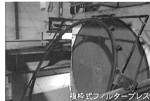
100.0m 3 /Hr 濁水処理設備
