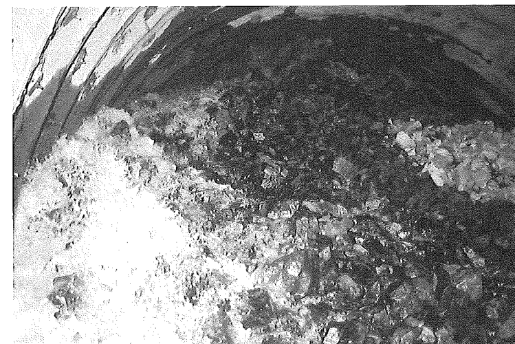
湧水と大規模崩落
