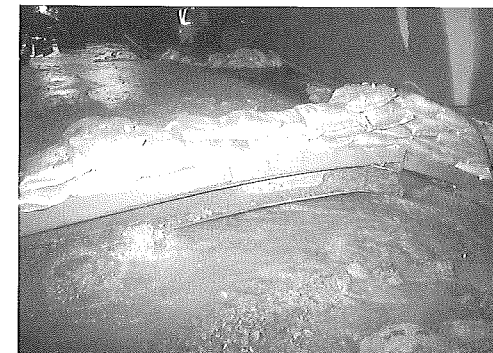
写真-4 ボイリングによる支保工の変形 16)
