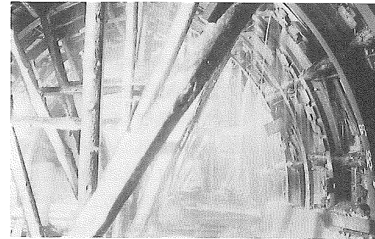
底設導坑湧水状況(志賀トンネル)
