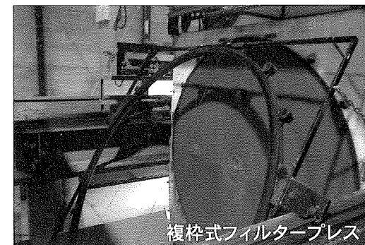
100.0m 3 /Hr 濁水処理設備
