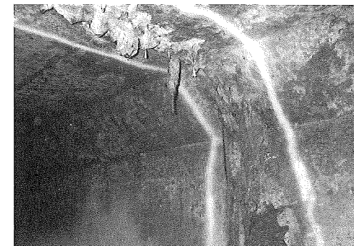
写真-7 打継ぎ目からの漏水
