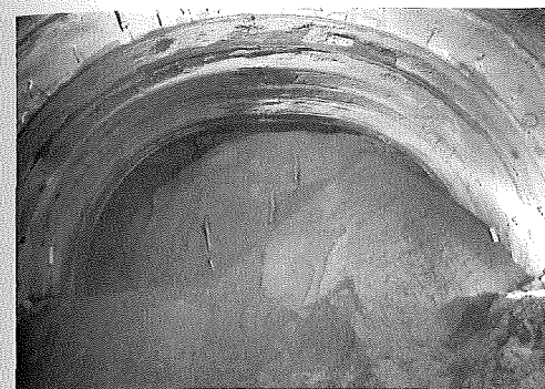
写真-5 右肩流砂発生状況(TD757m, 対策工120°)
