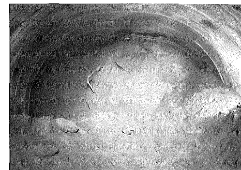
写真-6 側壁部崩壊状況(TD967m, 対策工140°)
