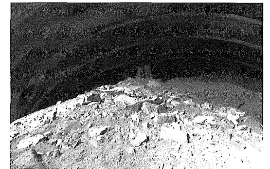
写真-4 天端崩落発生状況 (TD702m地点)
