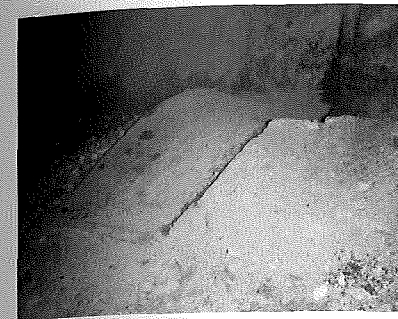
写真-4 消火栓箱抜き部周辺の変状(後行下り線)
