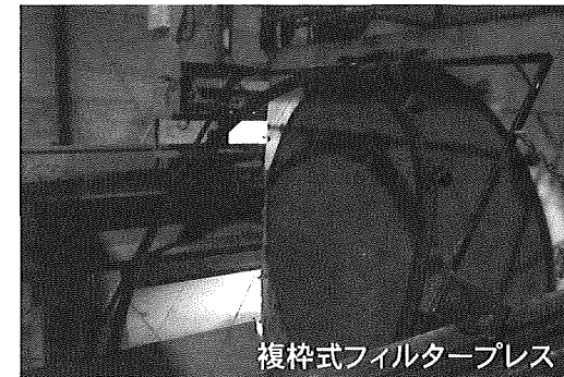
100.0m 3 /Hr 濁水処理設備
