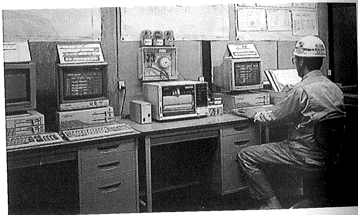
太田幹線その4工事計測管理システム
