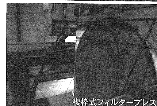
100.0m³/Hr 濁水処理設備
