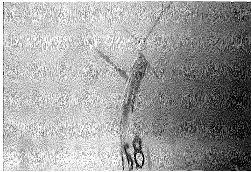
写真-2 既設導水路ひび割れ状況
