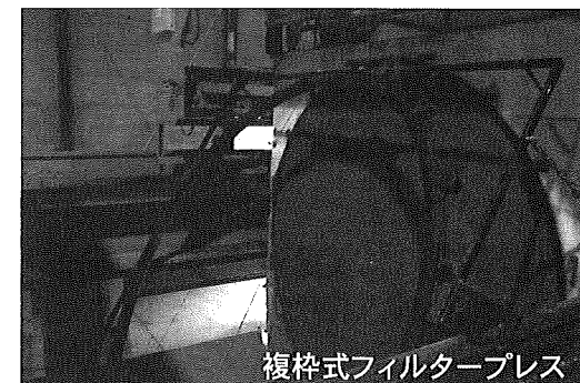
100.0 m³/Hr 濁水処理設備
