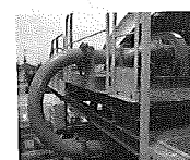
配管切替装置
