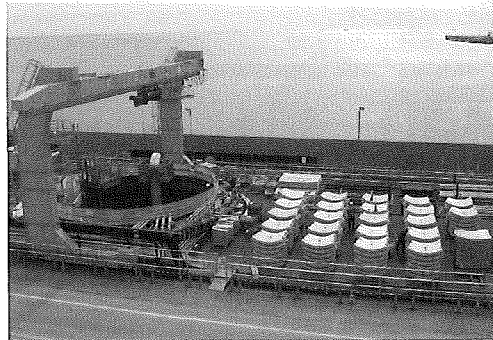
写真-2 橋形クレーンによるセグメント荷下ろし状況 (川越側)
