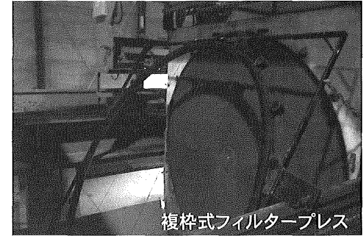
100.0m³/Hr 濁水処理設備
