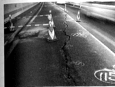
写真-2 舗装面の隆起状況
