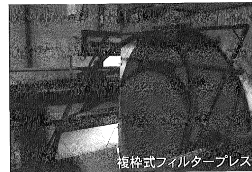
100.0m 3 /Hr 濁水処理設備
