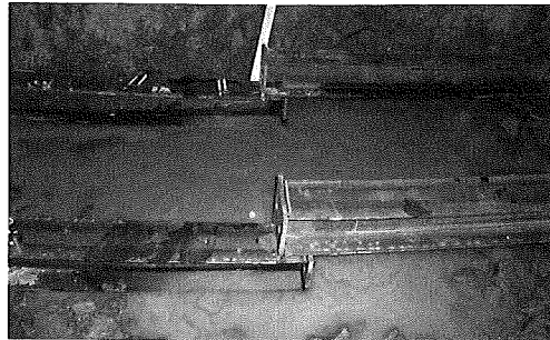
写真は鋼製ストラットが設置不可能となった状況
