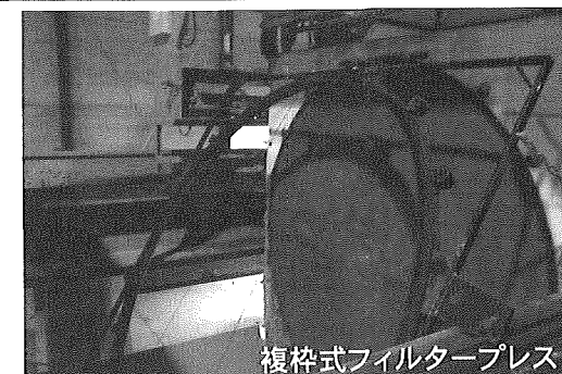
100.0m 3 /Hr 濁水処理設備
