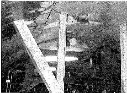
写真-1 ライニングの損傷状況
