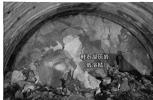
写真-3 変状区間Aの切羽崩壊
