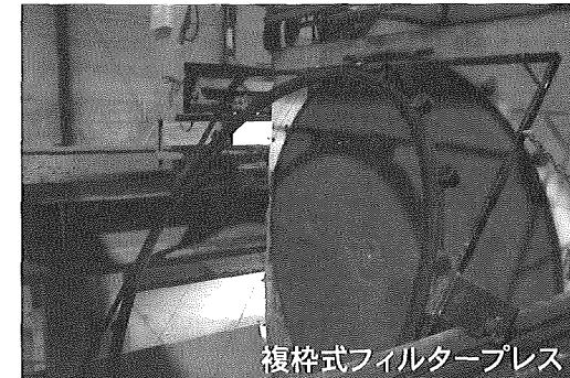
100.0 m 3 /Hr 濁水処理設備
