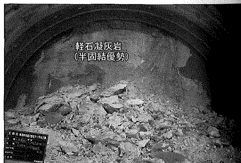
写真-5 変状区間Bの切羽崩壊
