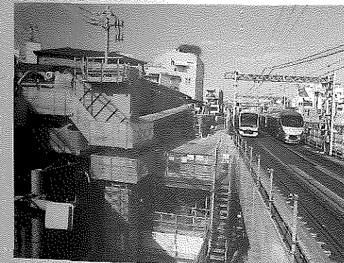
写真は地上部垂直ベルトコンベヤ
