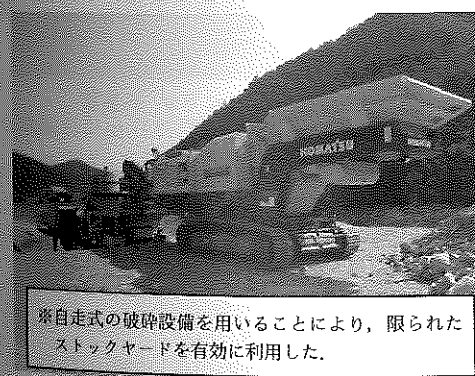
写真-2 自走式一次破碎設備
