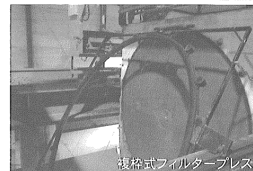
100.0m 3 /Hr 濁水処理設備
