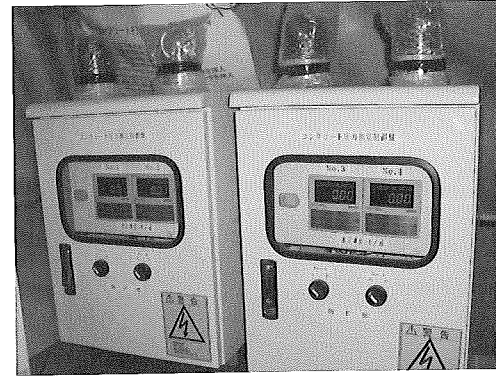
写真-8 側圧管理制御盤
