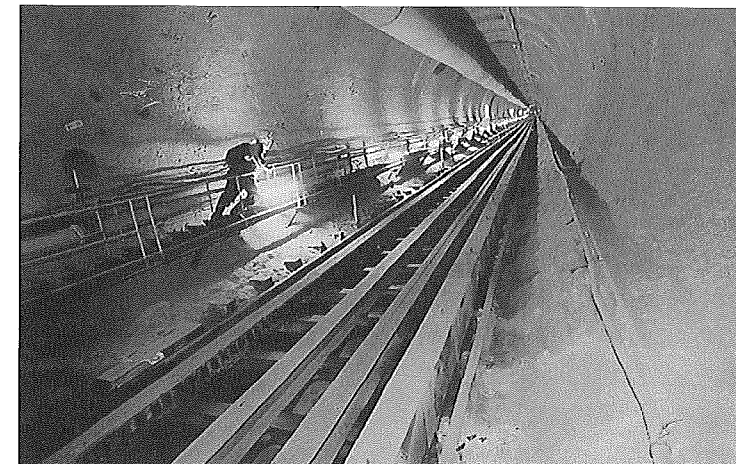
神流川斜坑の昇降設備
