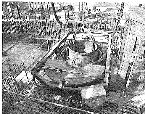
写真-7 スライド消音装置
