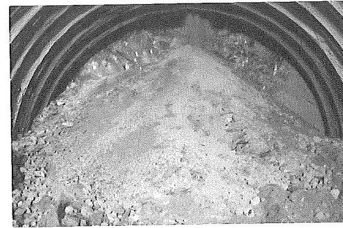
写真-2 天端崩落状況 (STA.134+47.2)
