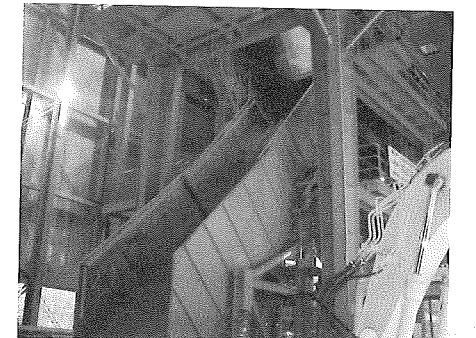
写真-5 ずりキブル転倒状況
