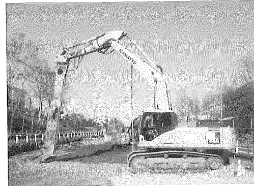
写真-1 国道交差部における地山改良工状況(表層混合処理工法)
