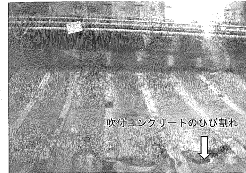
写真-3 インバートの変状
