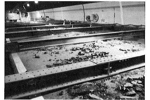
(2) 9月10日 路面隆起状況
