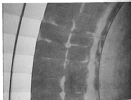
EPSパネル取り外し直後の状態
