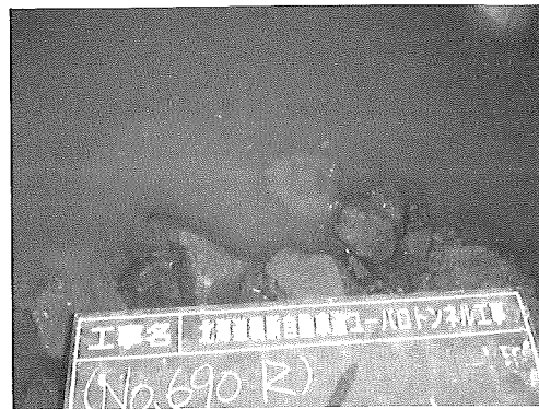
写真-1 メタンガス湧出状況
