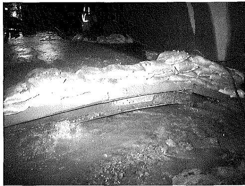
写真-6 2回目の変状状況(ボイリング状崩壊)
