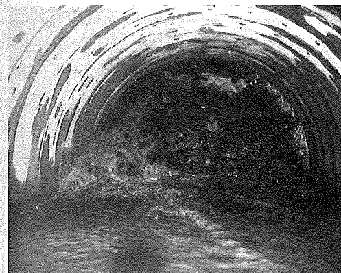
写真-1 突発湧水発生状況
