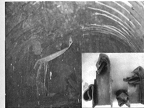
写真-5 1回目の変状状況(支保工の圧壊)
