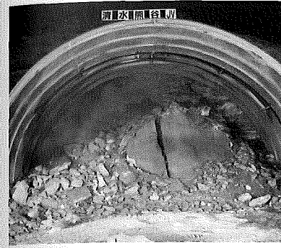
写真-4 切羽崩壊状況(本坑坑口DIII-1掘削時)
