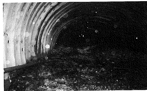
写真-4 崩落状況(228km340m付近)
