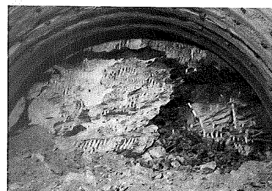
写真は切羽崩落状況(葉片状蛇紋岩)
