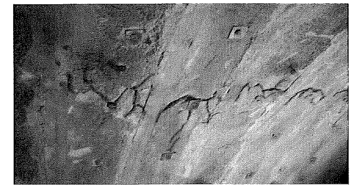
写真-7 吹付けコンクリートのクラック発生状況
